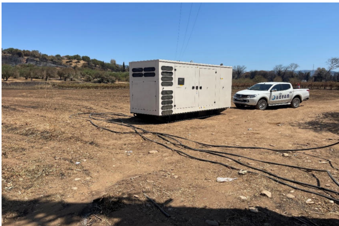
(Φωτό 7, γεννήτρια 400kva που μετέφερε ο ΔΕΔΔΗΕ με φορτηγό της ΔΕΥΑΠ, στη γεώτρηση Μοιρέικα 1)
